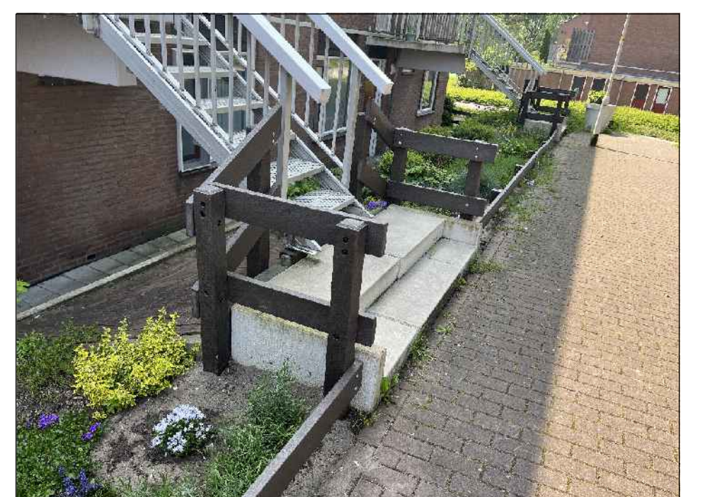
F1 (foto) bij trappen toegang woning hekwerk met twee planken (totaal ca. xx m1)
